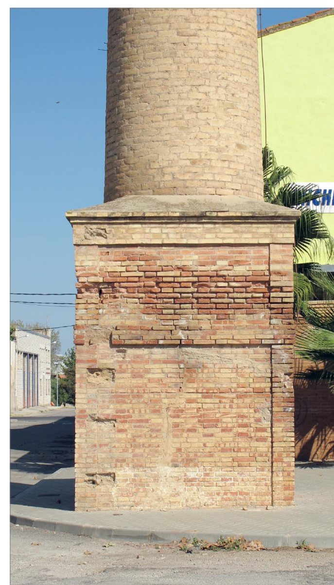
IMATGES DE PATOLOGIES
